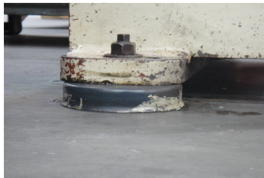
Figura 6 – Amortiguador de vibración con baja eficiencia
