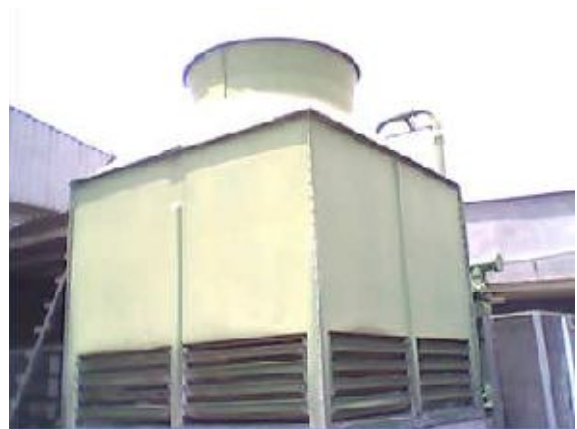
Fig 1 Ventilador de torre de enfriamiento
